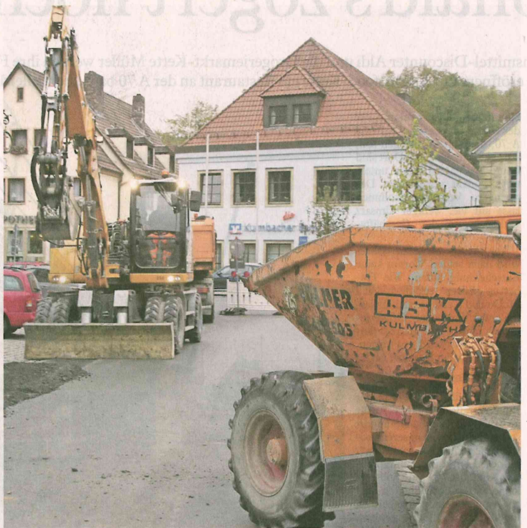
Der Kasendorfer Ortskern ist Baustelle. Die Staatsstraße zwischen Kasendorf und Thurnau ist gesperrt.
