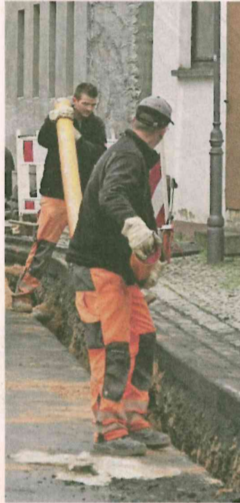
Bauarbeitern legen in der Thurnauer Straße Leitungsrohre in den Untergrund. Fotos: Alexander Hartmann
