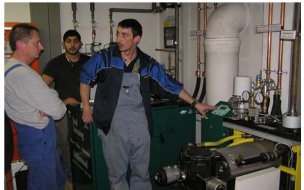
Inbetriebnahme der Anlagen in unserem Verwaltungsgebäude am 06.12.2006. Bei der Anlage im Vordergrund wurde die Verkleidung zu Demonstrationszwecken abmontiert.
